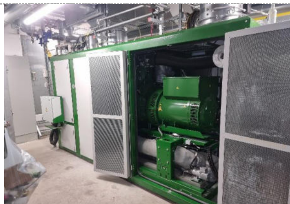
E.M.E. Blockheizkraftwerk (H2-ready), Schloss Montabaur
