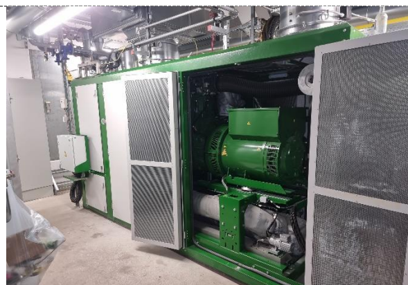
E.M.E. Blockheizkraftwerk (H2-ready), Schloss Montabaur
